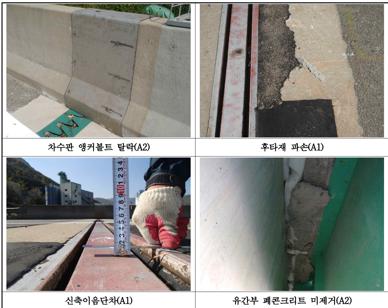
【사진 3.2.14】 신축이음장치 손상현황(대구)
