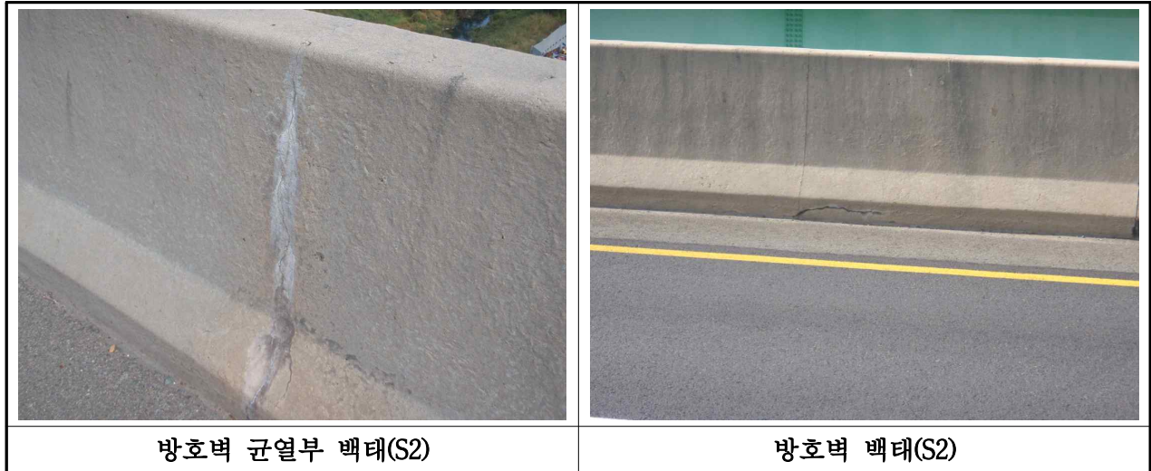
【사진 3.2.21】 방호벽 손상현황(대구)
