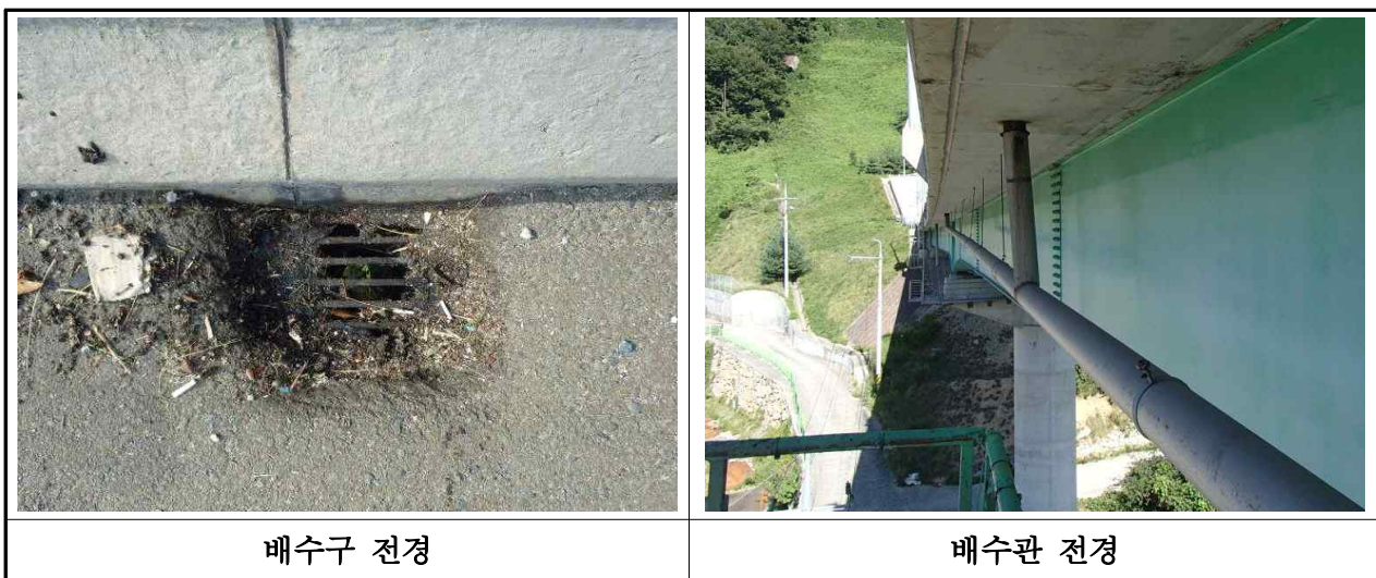
【사진 3.3.18】 배수구 및 배수관 전경(부산)
