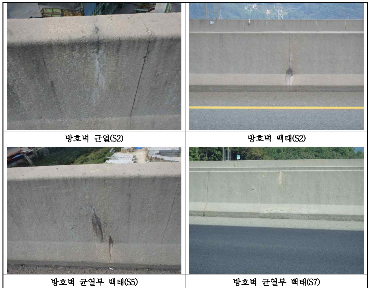
【사진 3.3.21】 방호벽 손상현황(부산)
