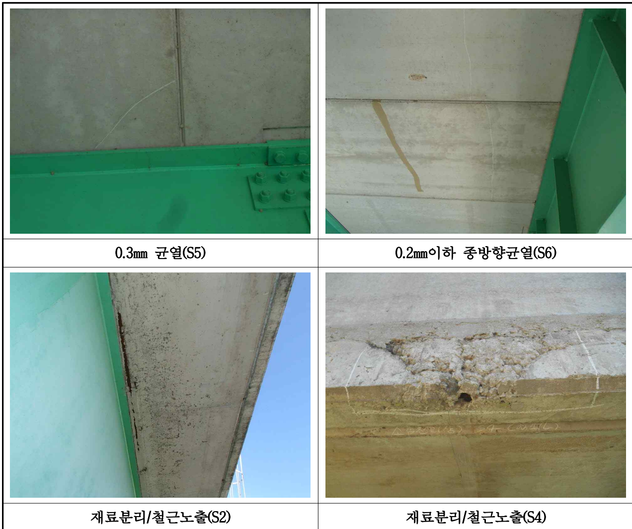
【사진 3.2.2】 바닥판 손상현황(대구)
