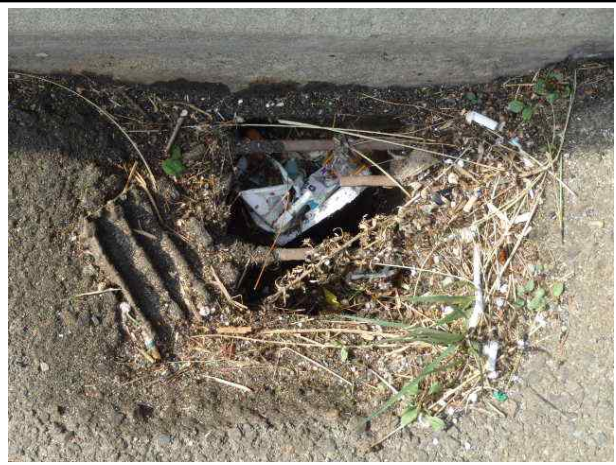
배수구 덮개 파손(S7)
