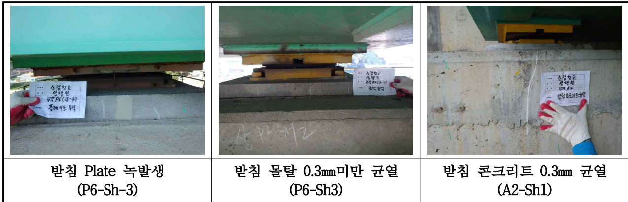
【사진 3.2.12】 교량받침 손상현황(대구)
