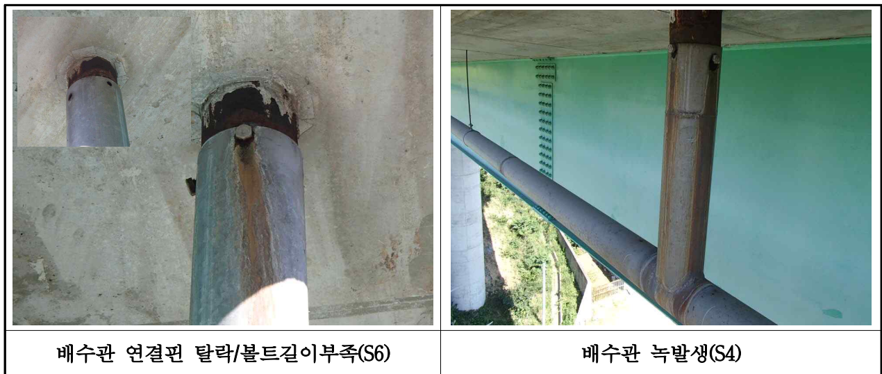
【사진 3.2.19】 배수시설 손상현황(대구)
