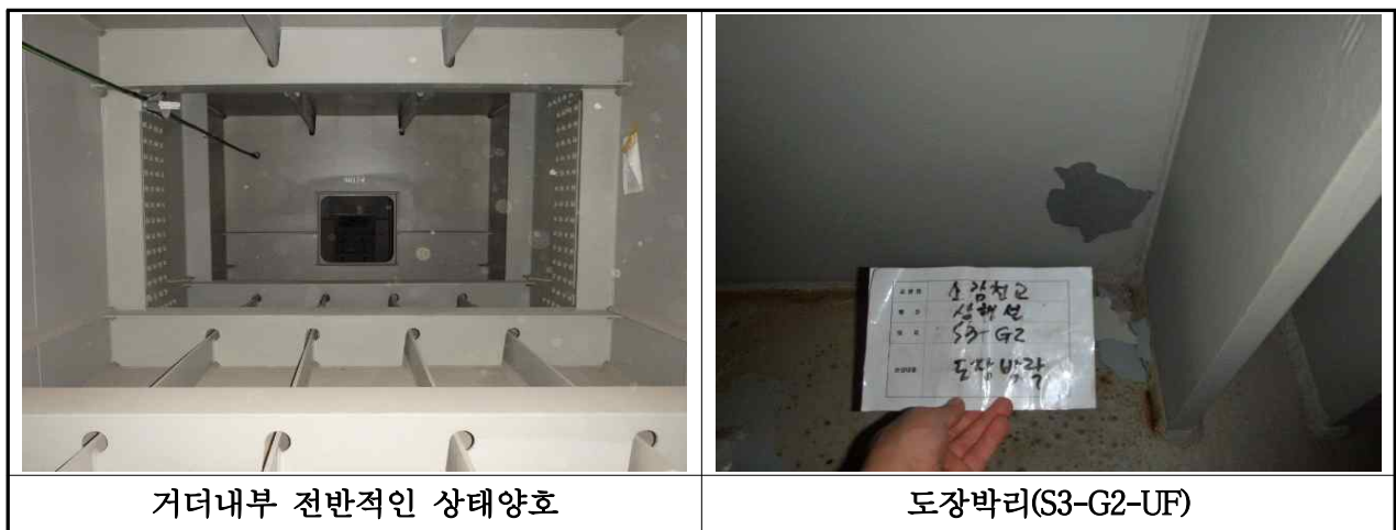
【사진 3.2.4】 강박스 거더 내부 손상현황(대구)
