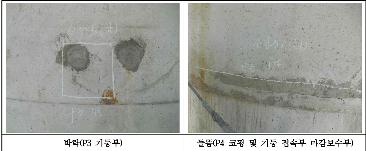
【사진 3.3.10】 교각 손상현황(부산, 계속)
