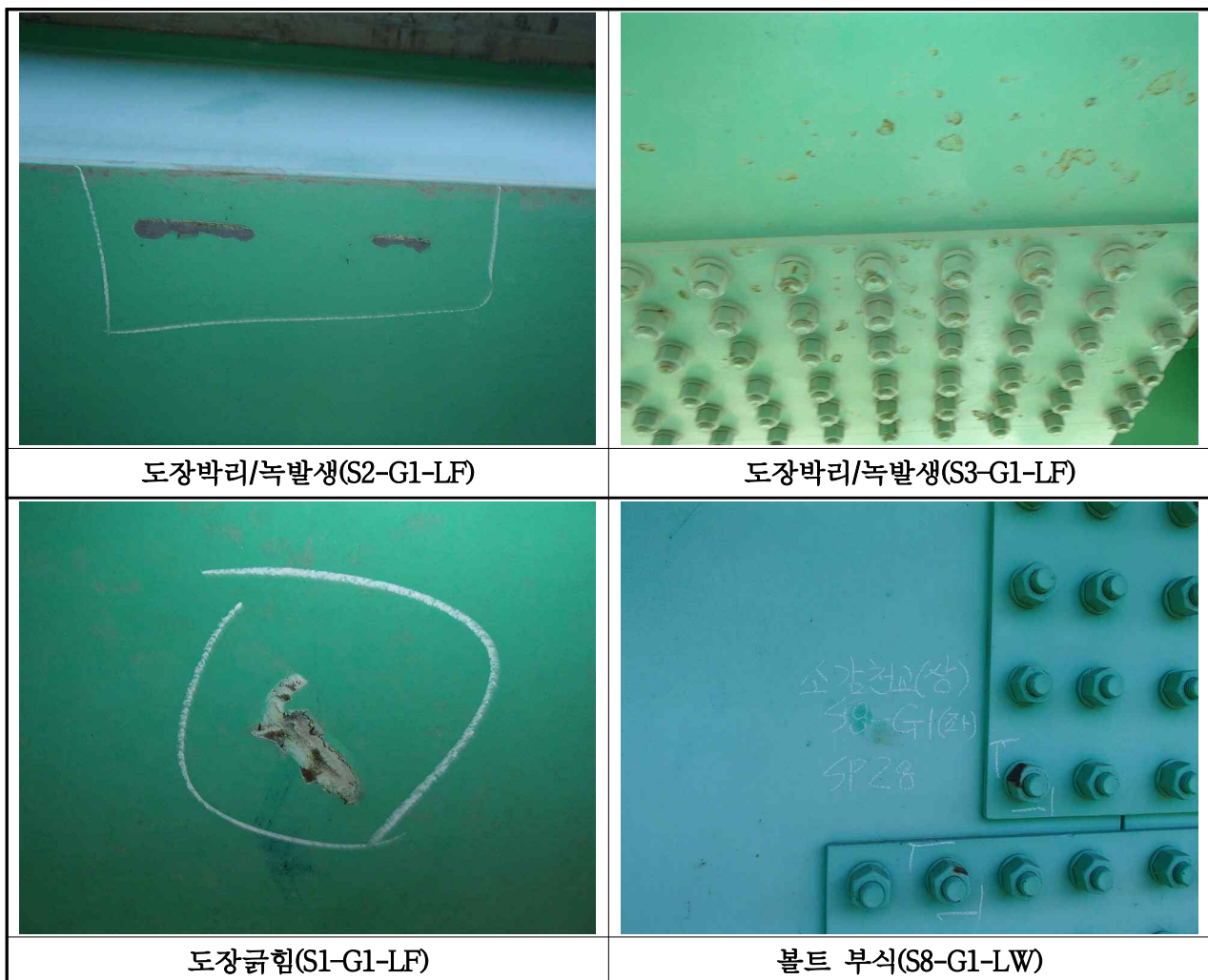
【사진 3.2.5】 강박스 거더 외부 손상현황(대구)
