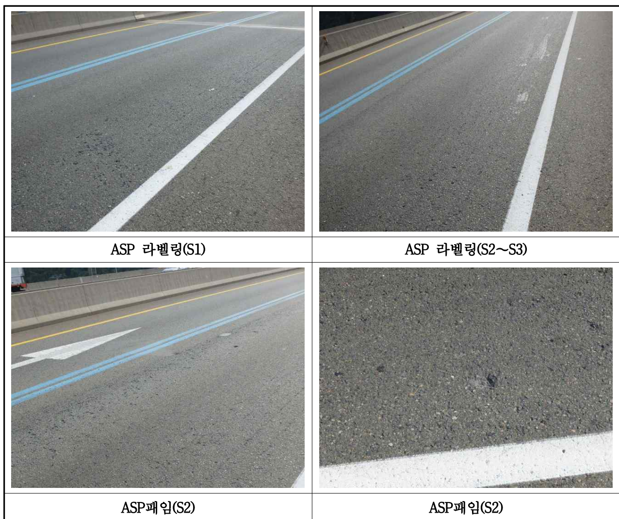
【사진 3.3.17】 교면포장 손상현황(부산)
