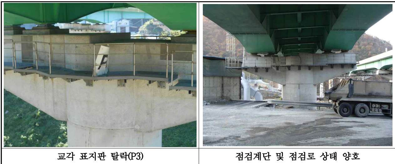
【사진 3.3.22】 기타 시설 손상현황(부산)
