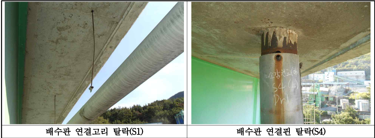
【사진 3.3.19】 배수시설 손상현황(부산, 계속)
