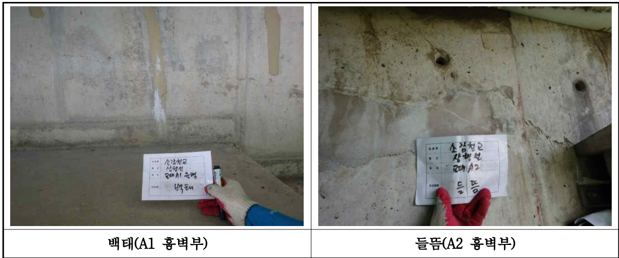
【사진 3.2.8】 교대 손상현황(대구, 계속)
