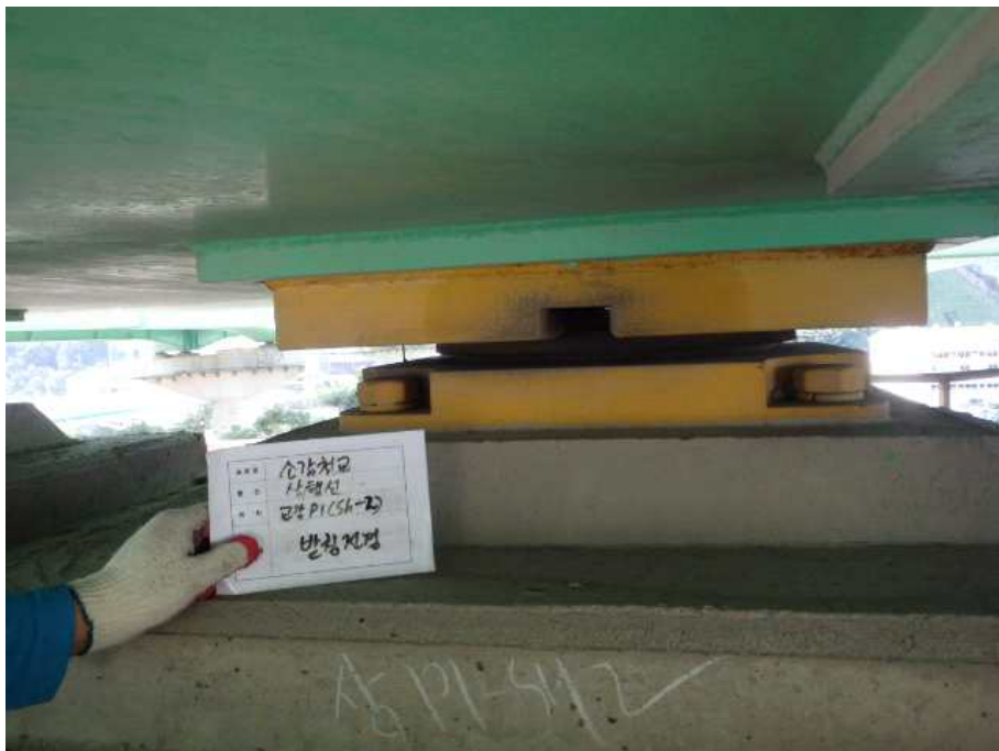
받침장치 전경 (가동단)
