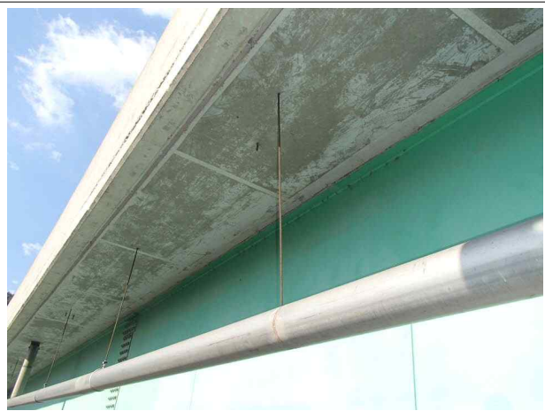
배수관 연결재 탈락(S2)
