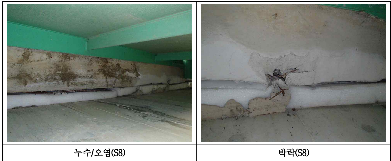
【사진 3.3.2】 바닥판 손상현황(부산, 계속)
