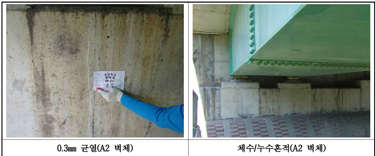
【사진 3.2.8】 교대 손상현황(대구)
