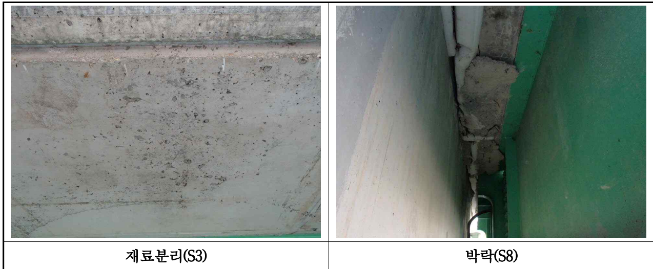
【사진 3.2.2】 바닥판 손상현황(대구, 계속)
