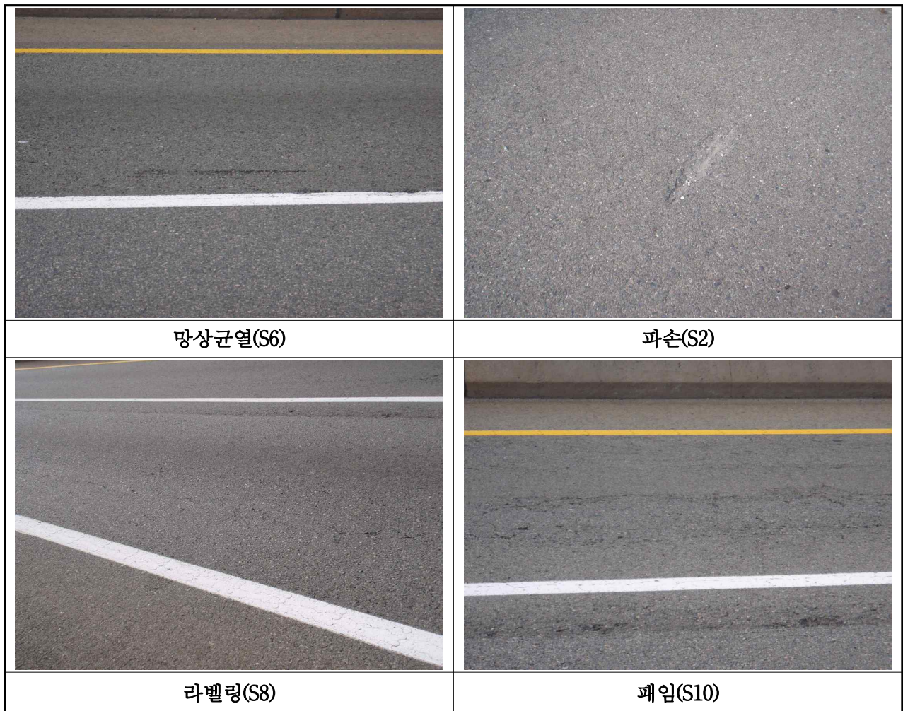
【사진 3.2.17】 교면포장 손상현황(대구)
